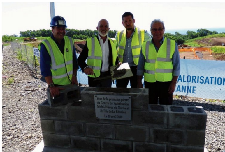
SYDNE et Inovert ont posé hier la première pierre du futur centre. Les élus de la Cirest étaient tous absents.
